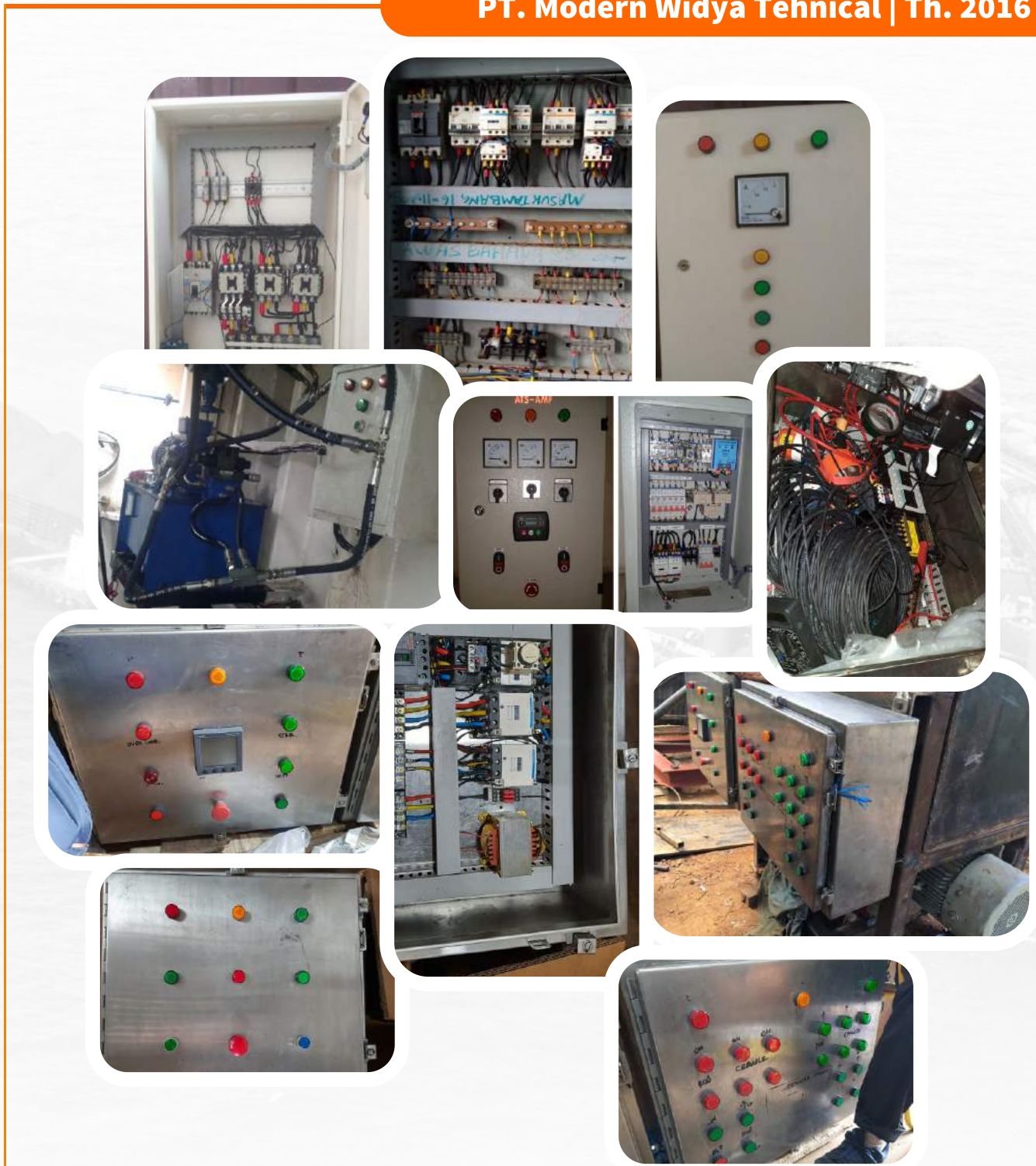
Project Instalasi Panel Elektrikal
